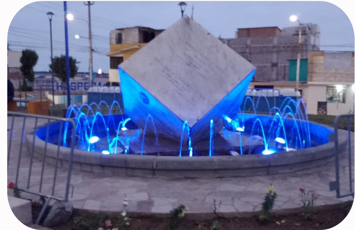
CIRCUITO DE AGUA EN PLAZA MIGUEL GRAU DE MATARANI - ISLAY - 2023
